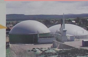
Biogas 및 고체성분 plant (50m3) Fermenter (3000m3), 일시 저장 장치 (5200m3)
